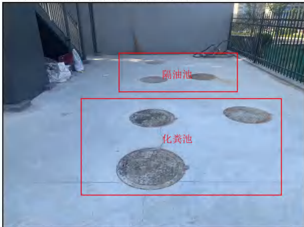
图 4-2 污水处理设施
