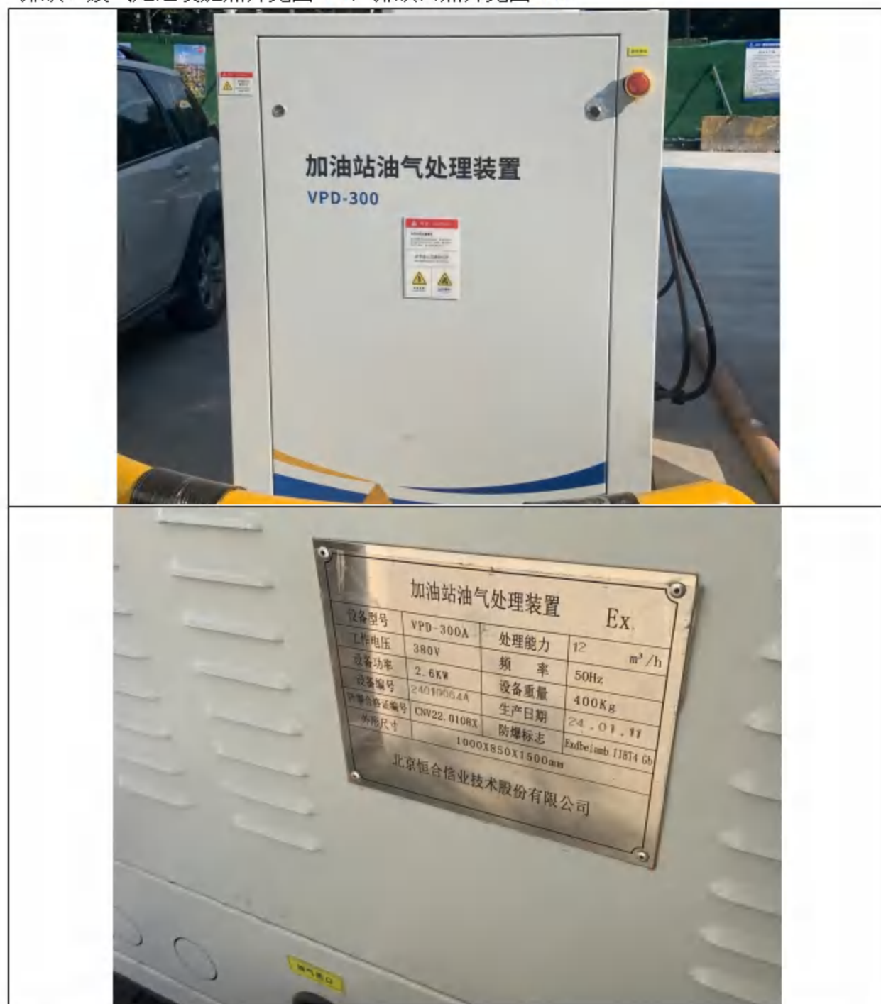
图 4-1 废气处理设施
